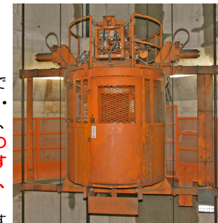
エレベータ(主立坑)
